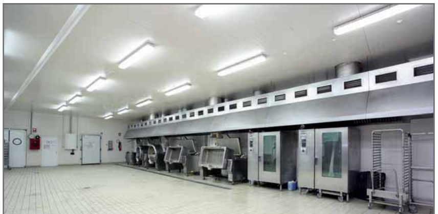
Vista de la cocina central (Rational).
